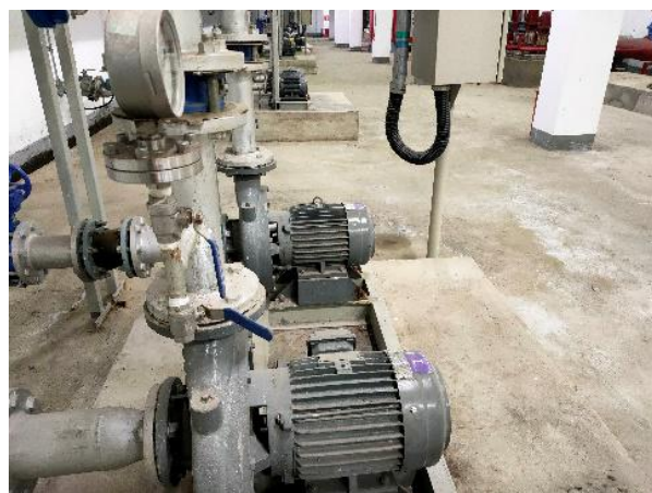
污水泵房水泵
