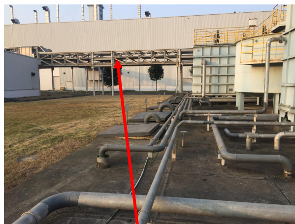
污水输送管线
