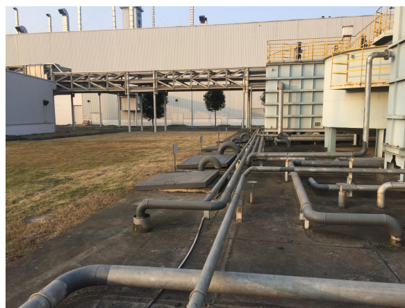
污水处理站管网
