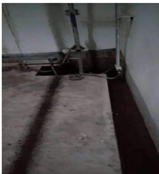
污水站负一楼泵房
