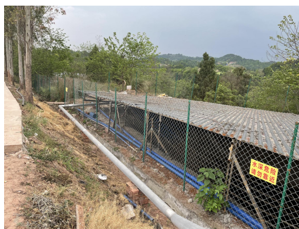
3#调节池（暂存池）
